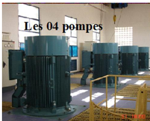
Figure 23 : les 04 Pompes de la Station de pompage
