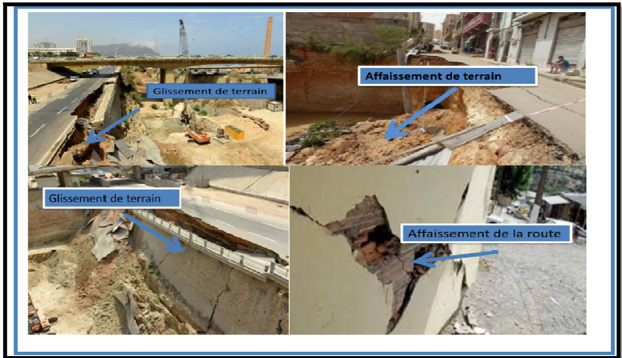
Fig. 18 : Des exemples d'affaissements et glissements à Oran centre
