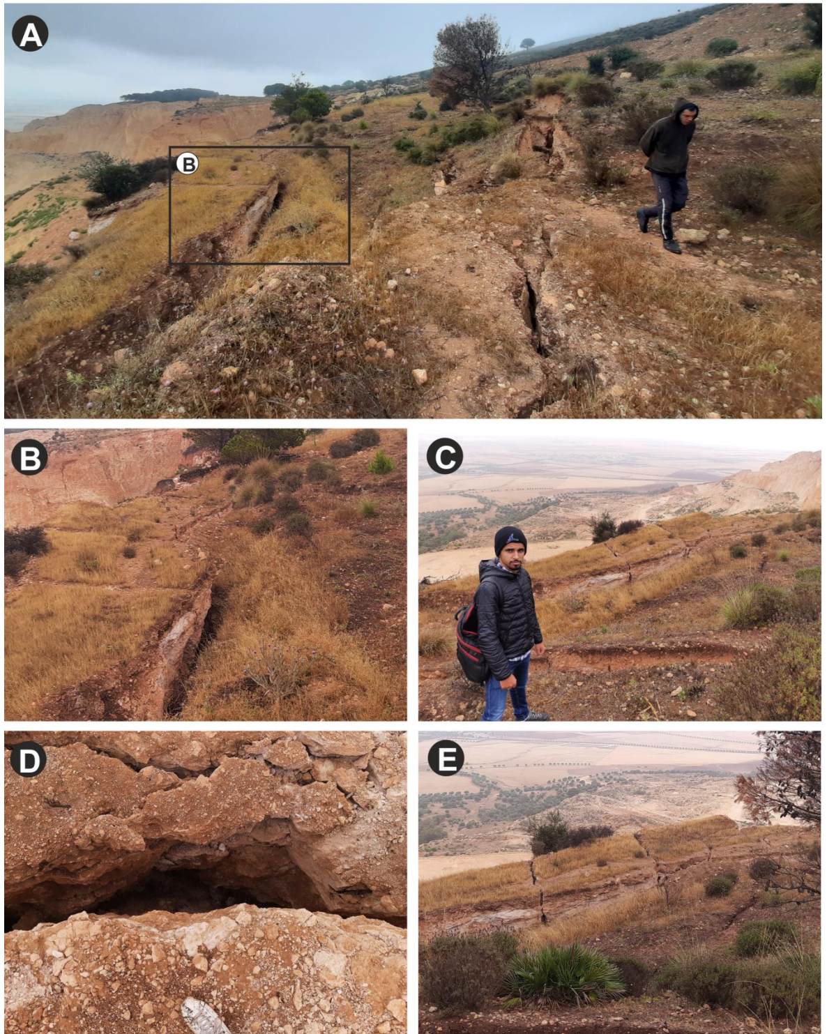
Fig. 26 : Impact de glissement sur les formations géologiques (partie Est de la carrière).
