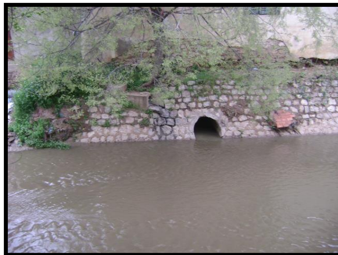
Figure 47: un point de rejet illicite quartier rocher
