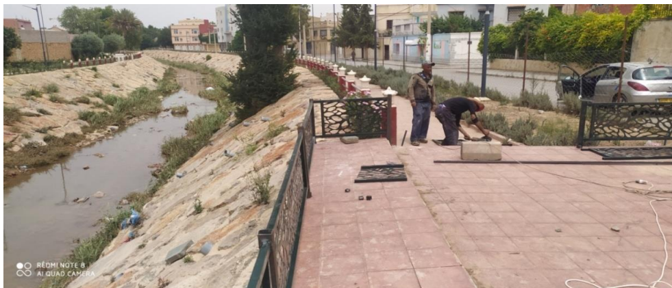
Photo travaux de bétonnage des canaux de protection contre l'inondation dans la ville de SIDI BEL ABBES
