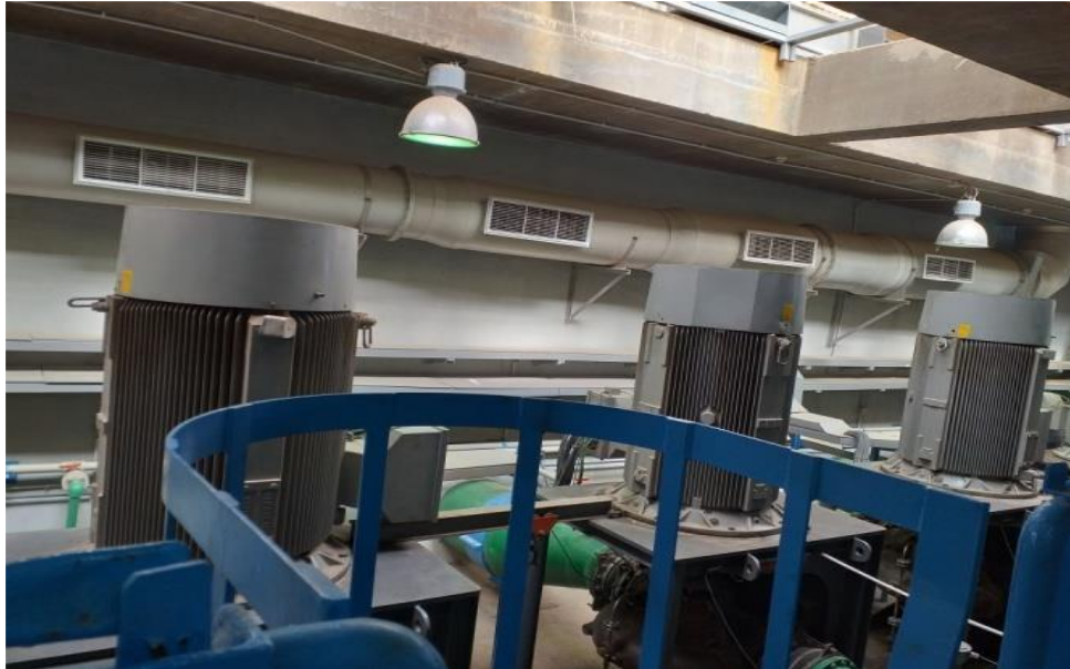
Figure II. 6: Le captage et pompage de l'eau de mer
