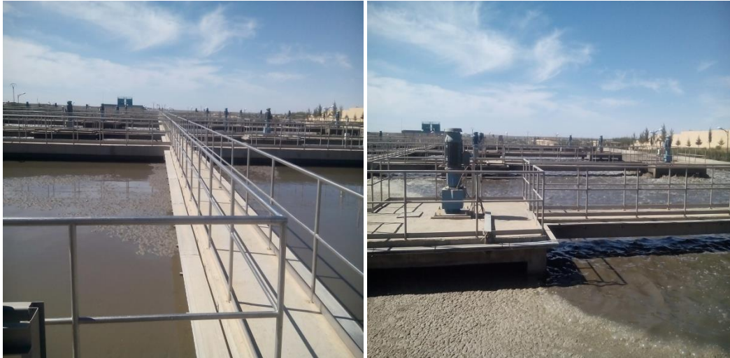
Figure 28: Bassin biologique (bassin d'aération)
