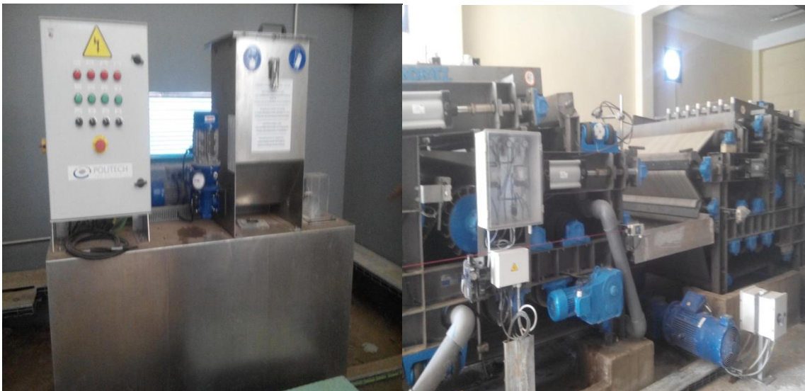
Figure 32: Déshydratation des boues de la STEP d' El Bayadh par le filtre à bandes presseuse
