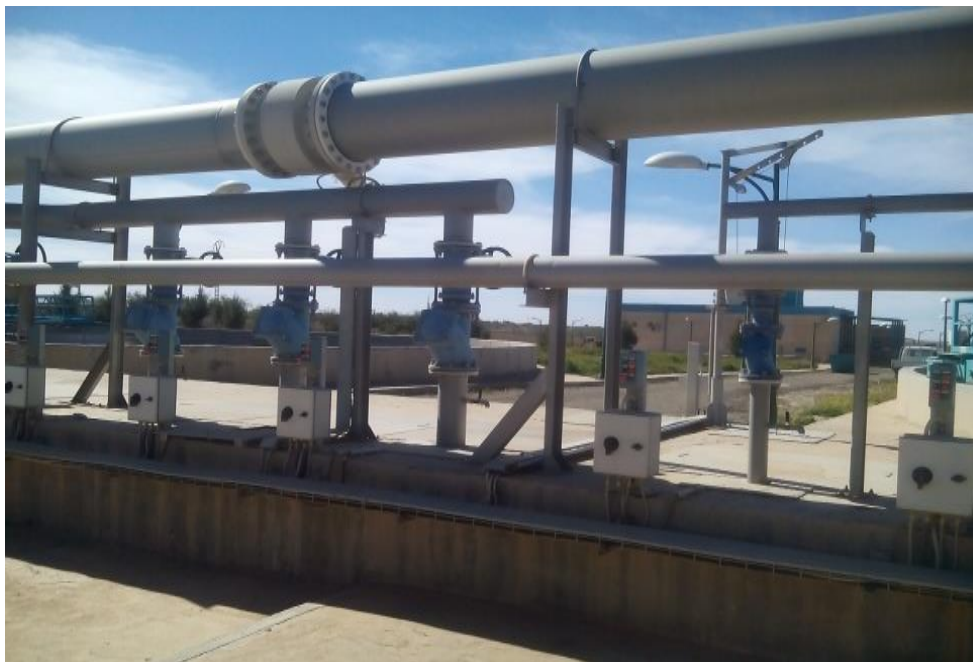
Figure35: Trois groupes d'électropompes destinées pour le pompage des boues en excès et des boues de recyclage.
