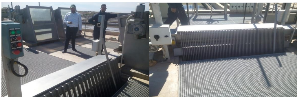
Figure 24 : Grille grossière manuelle Figure 25 : Dégrillage fin manuel.
