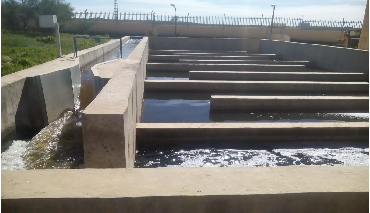
Figure 30: Bassin de désinfection de la STEP d' El Bayadh.
