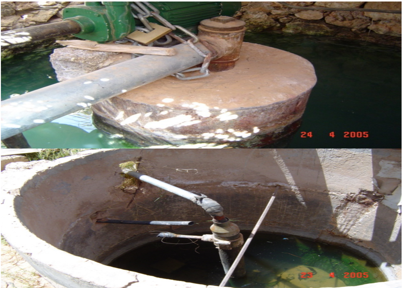
Figure 32: pollution de la nappe du C.I par sondage a l'intérieur d'un puits exploitant la nappe alluvionnaire
