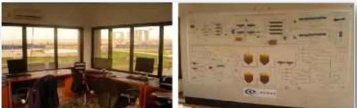
Figure n°18: Salle de contrôle
