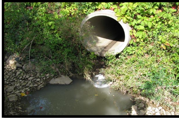
Photo. n°4 : Les eaux usées pluviales
