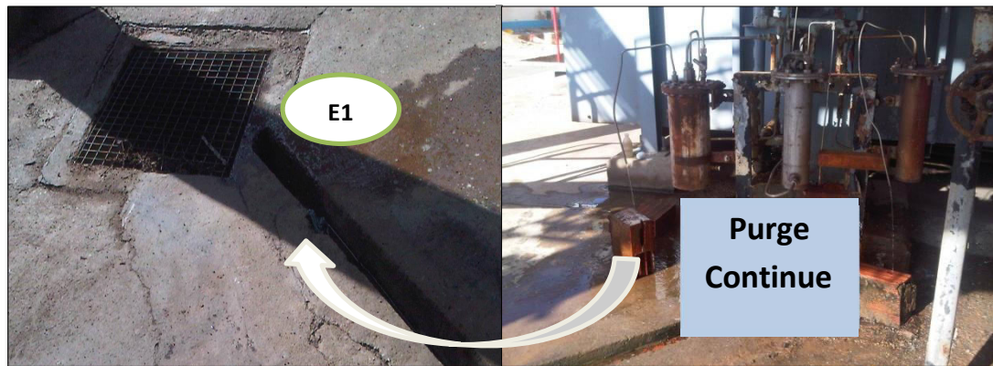
Fig. 2.2 : Purge continue de la chaudière ABB (Site E1).
