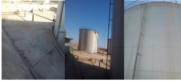
الشكل رقم (6) الخزانات التي تحتوي مياه مخصصة لاطفاء الحرائق
