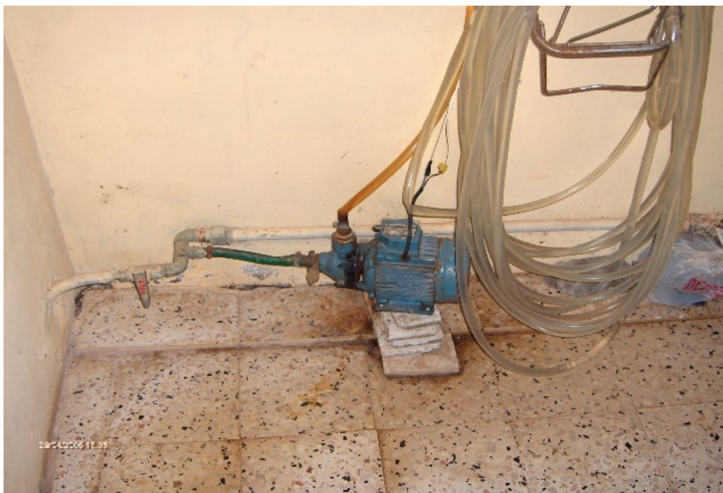
Photo N° 7 : moteur directement sur la canalisation à El Kerma en 2004.
