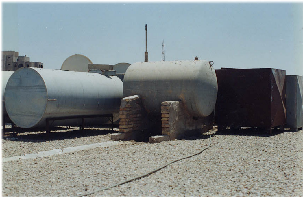
Photo N° 9 : Réservoir d'eau relié au réseau d'AEP, Es Salem en 2004
