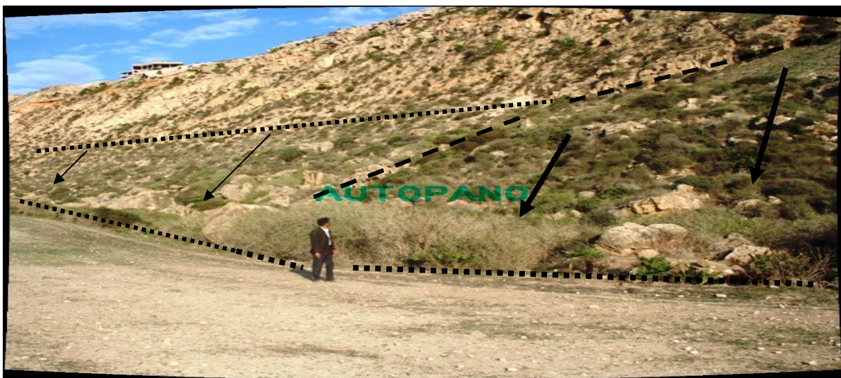
Fig.205 : Débris et blocs.
