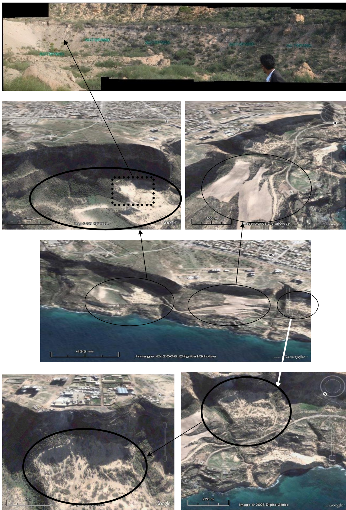
Fig.213 : suppressions partielles de la butée en pied de talus ( cercle noir : zone d'excavation de sables et grés)
