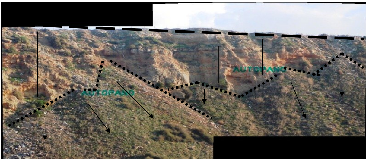
Fig.203 : Coulées de débris et de boue
