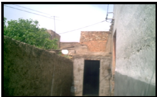
Photos N°64 : les murs décroûtés de leurs enduits
