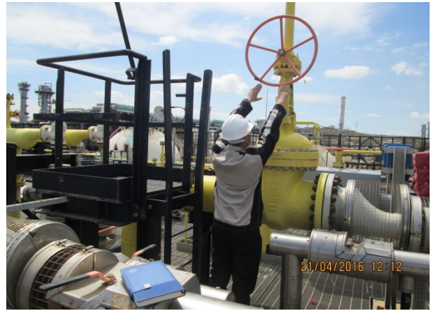
Figure 20 : mauvais emplacement de la plate-forme B
