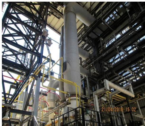
Figure 25.28 gaine aspiration (démontage difficile pour les besoins de maintenance.
