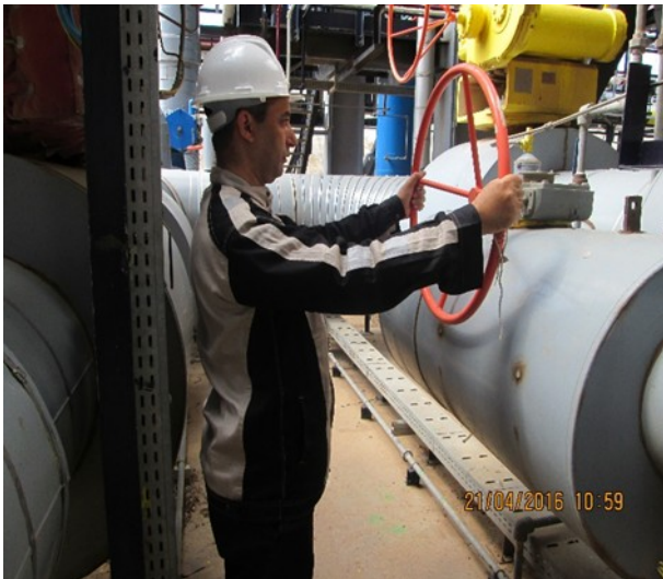
Figure 25.15 une vanne accessible
