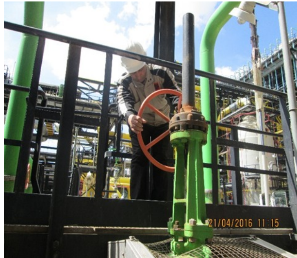
Figure 25.26 une vanne difficilement accessible (b)
