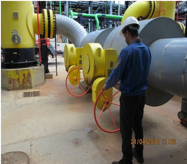
Figure 25.13 une vanne bien orientée pour faciliter son exploitation par l'opérateur
