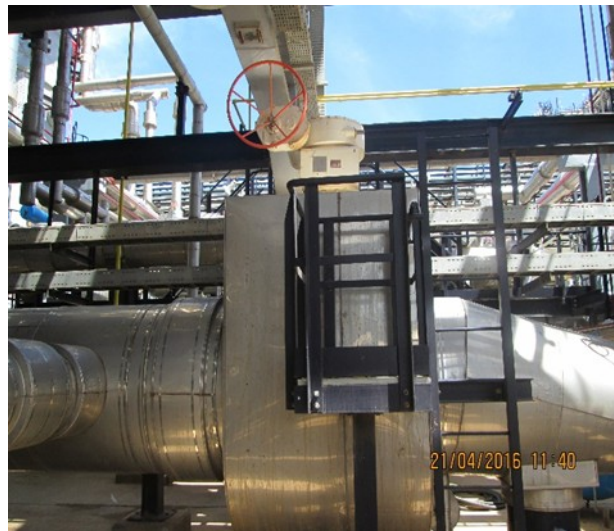
Figure 25.10 une plateforme de mauvaise conception
