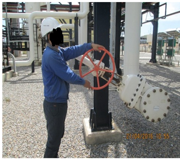
Figure 25.18 une vanne accessible
