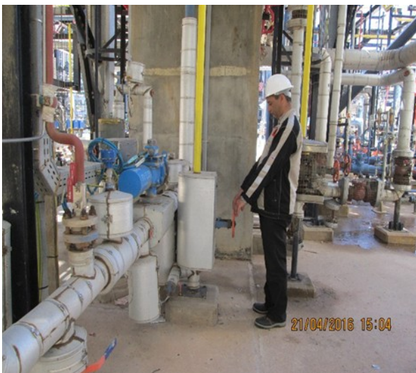
Figure 25.17 une vanne inaccessible
