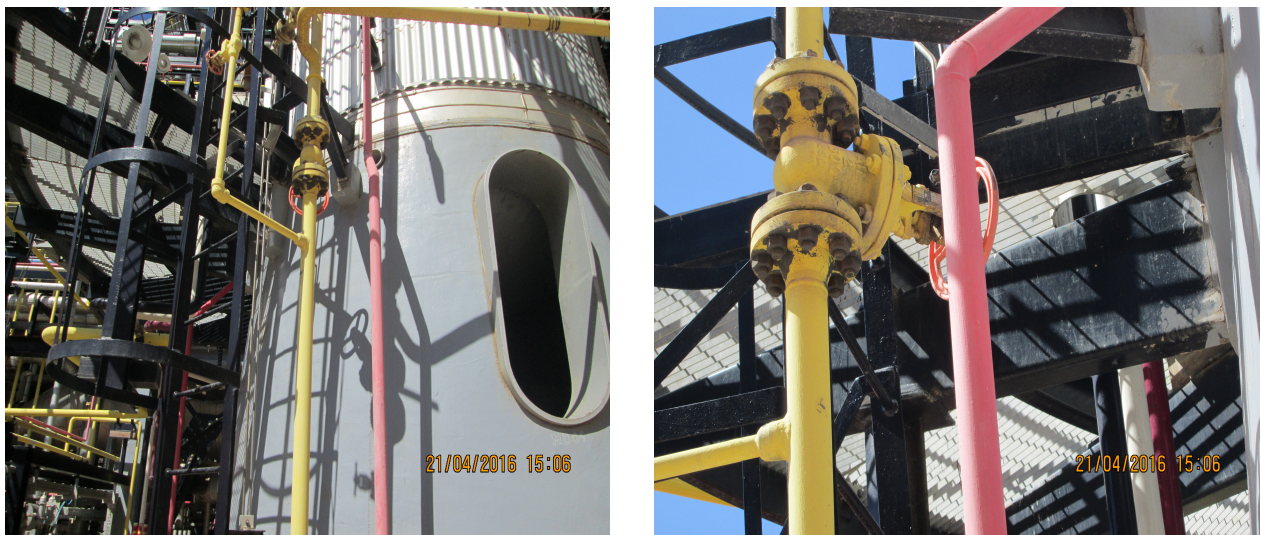
Figure 26 : vannes mal orientées
