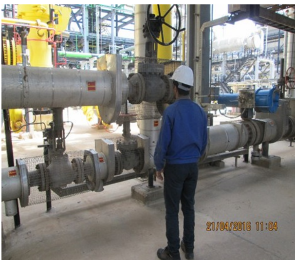
Figure 25.23 une vanne inaccessible (haut)
