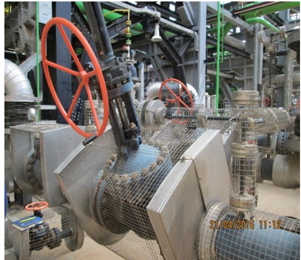
Figure 25.14 une vanne bien orientée pour faciliter son exploitation par l'opérateur
