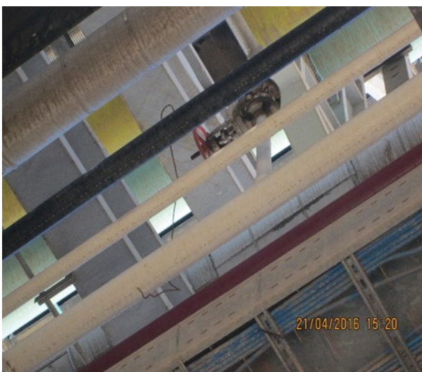
Figure 25.05 une vanne inaccessible
