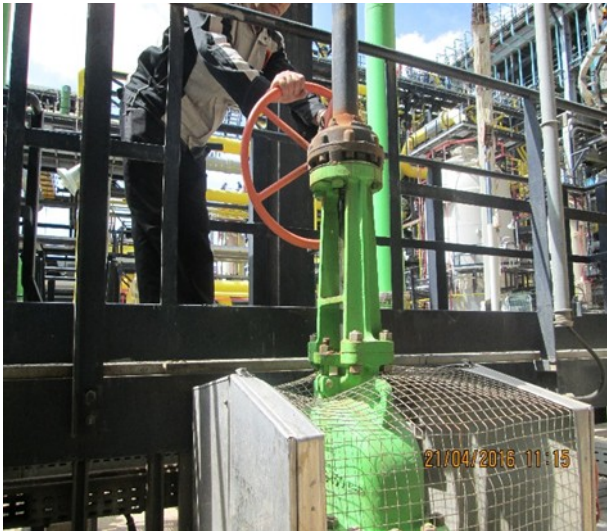
Figure 25.25 une vanne difficilement accessible (a)
