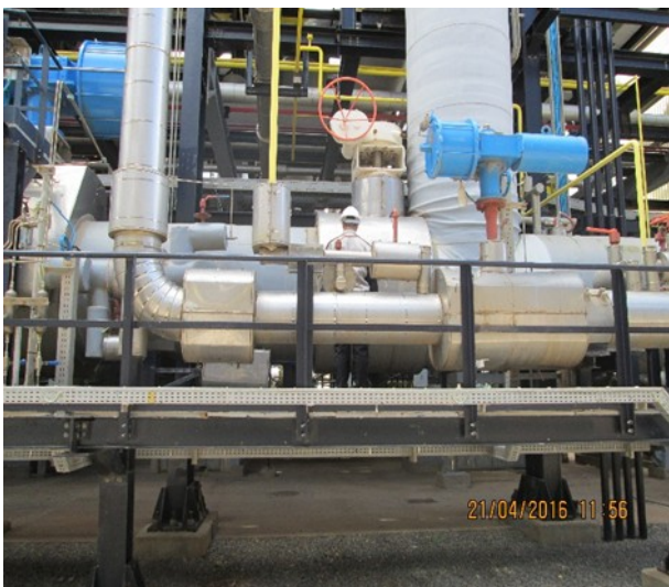
Figure 25.27 une vanne difficilement accessible par l'opérateur (tres haut)
