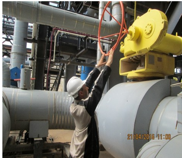
Figure 25.16 une vanne inaccessible
