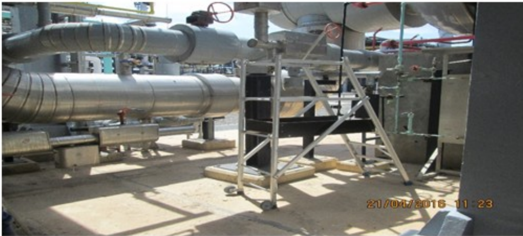
Figure 27 : échelle mobile pour exploiter deux vannes
