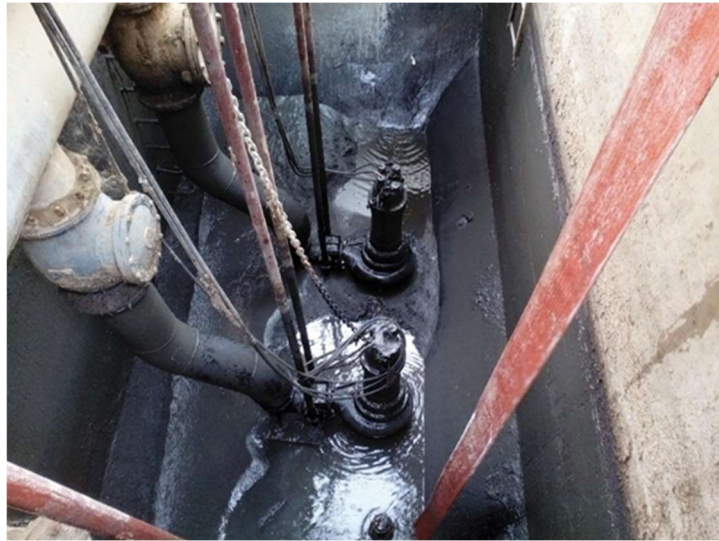
Figure II.14 : Les pompes de relevage.
