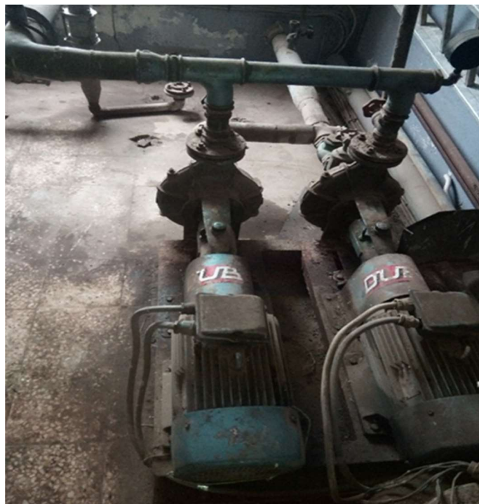
Figure II.21 : Pompes d'eau de service.
