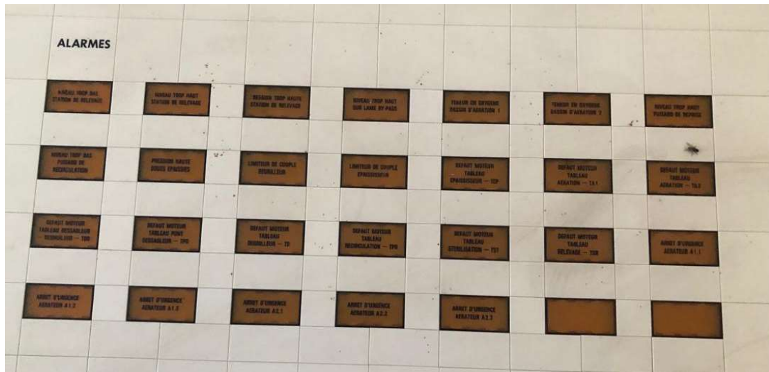
Figure III.3 : Indicateurs lumineux et alarmes de la STEP.
