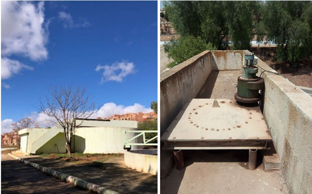
Figure II.12 : La salle d'épaississement.
