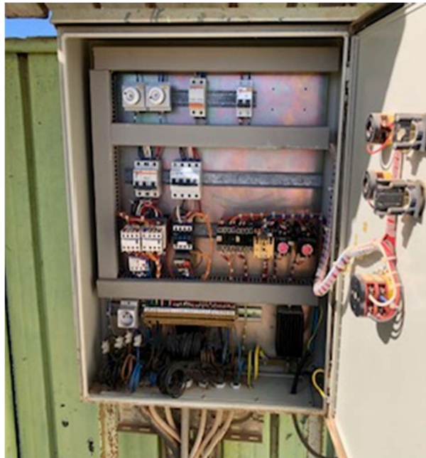
Figure II.35 : Armoire électrique du dégrilleur.
