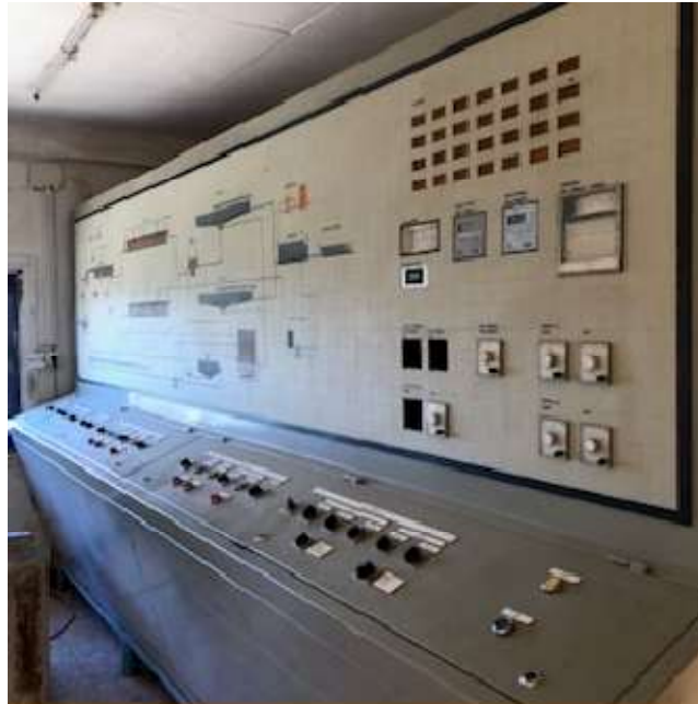
Figure III.1 : Salle de contrôle.
