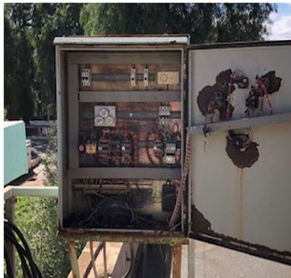
Figure II.34 : Armoire électrique de dessableur / déshuileur.
