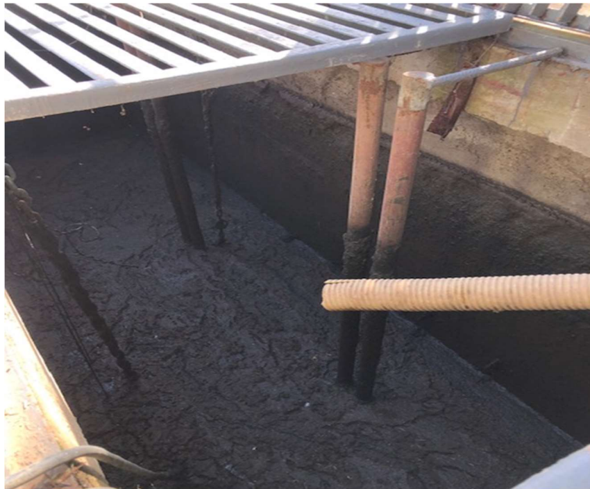
Figure II.11 : Les boues qui proviennent du décanteur.
