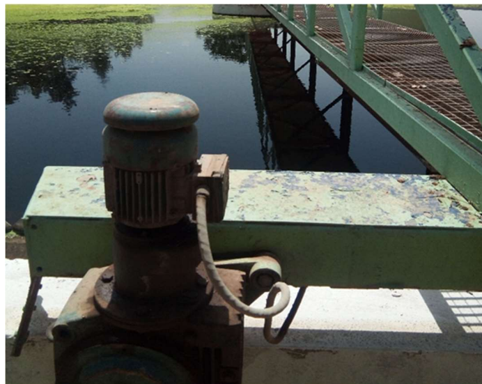
Figure II.26: Motoréducteur de décanteur.
