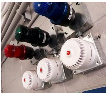
Figure II.60 Des alarmes dans un site industriel
