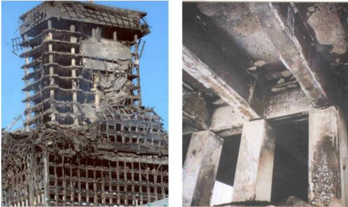
Figure 2. 1 À gauche, photo du bâtiment Windsor à Madrid après l'incendie. À droite, dessous du tablier du pont à Bruxelles après l'incendie (29)
