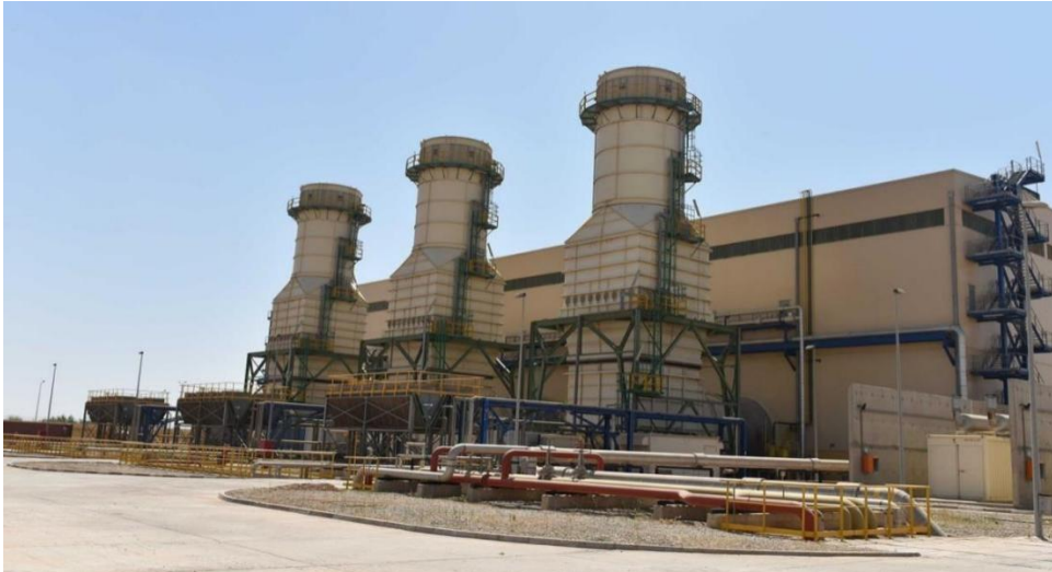
Figure 10. Centrale électrique à cycle combiné RELIZANE
