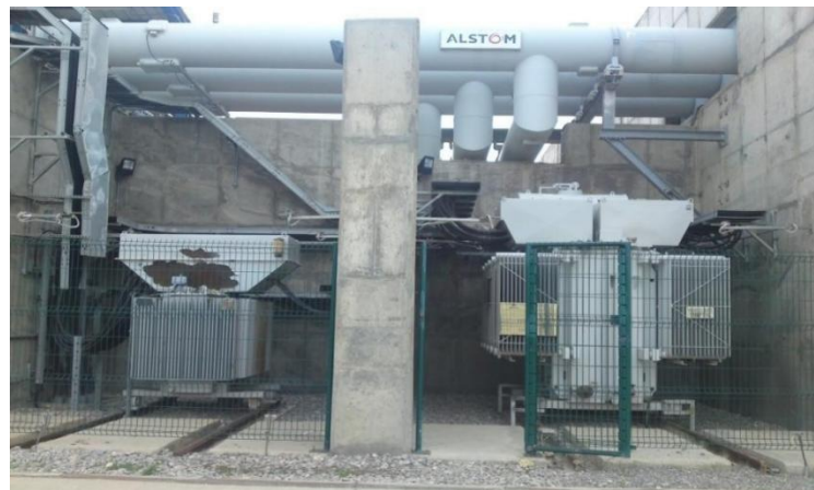
Figure 21. Transformateurs Auxiliaire et de Démarrage
