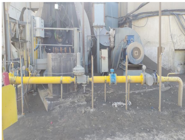
FigureII.4 : Rampe de robinetterie à gaz[3]
