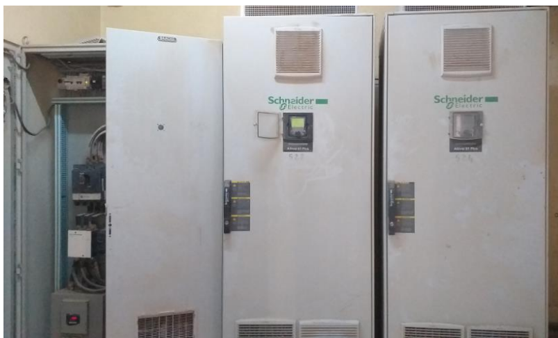
Figure II.8 : Armoire des variateurs [5]
