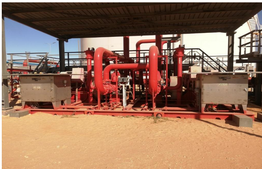
Figure 4.4 Pompes électriques P3201A/B
