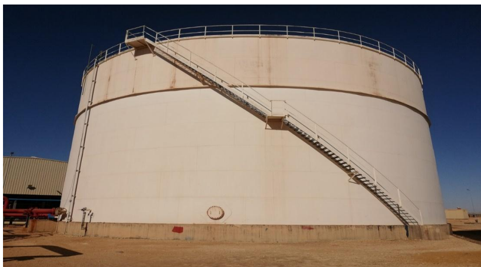
Figure 4.1 Bac d'eau incendie T3201
