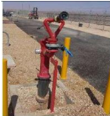
Figure 2.16 Lance monitor connectée sur le réseau maillé enterré [12]
