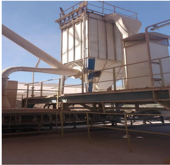
Figure 24: filtre à manche
