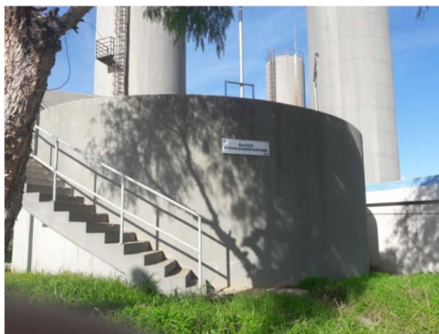
Figure III.10 : Le bassin d'homogénéisation
