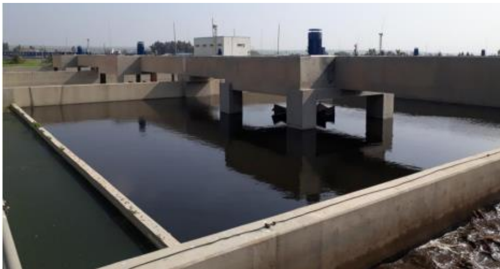
Figure III.5 : Bassin d'aération de la station d'épuration.
