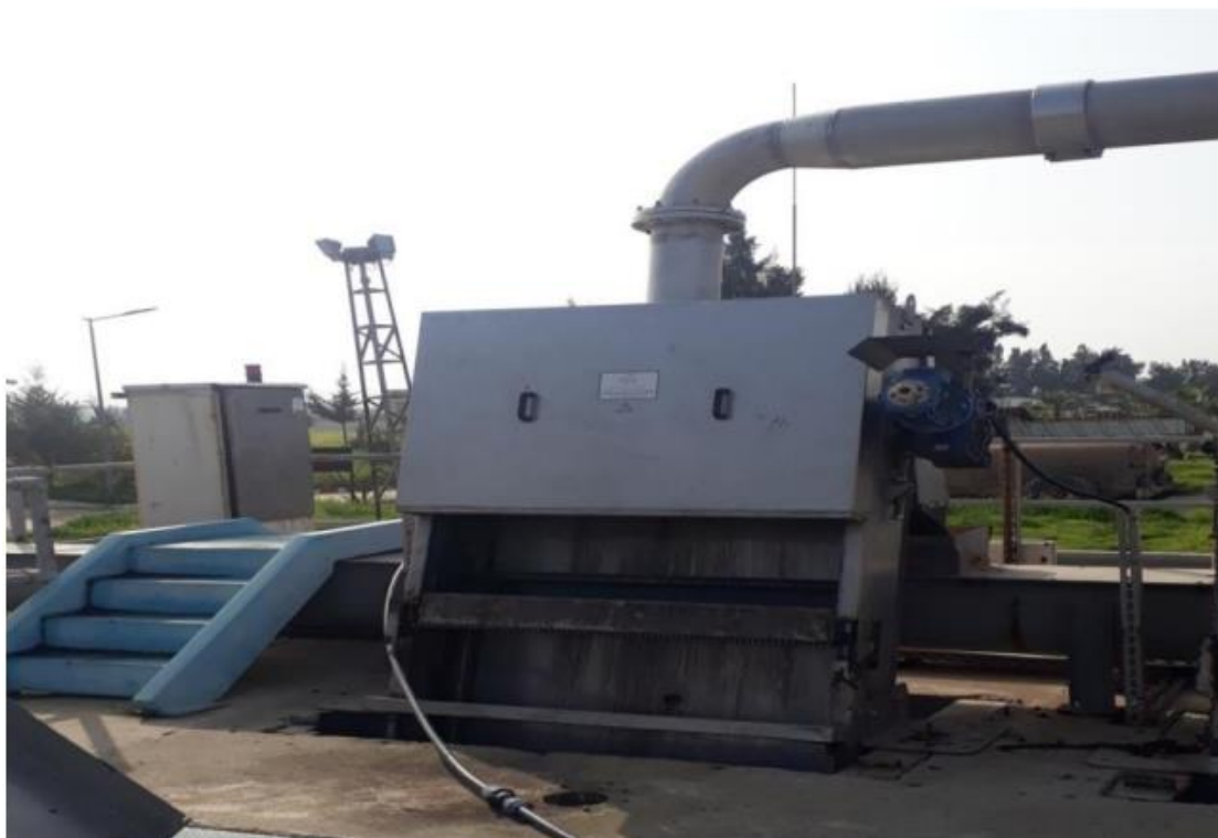
Figure III.2 : Dégrilleur fin mécanique
