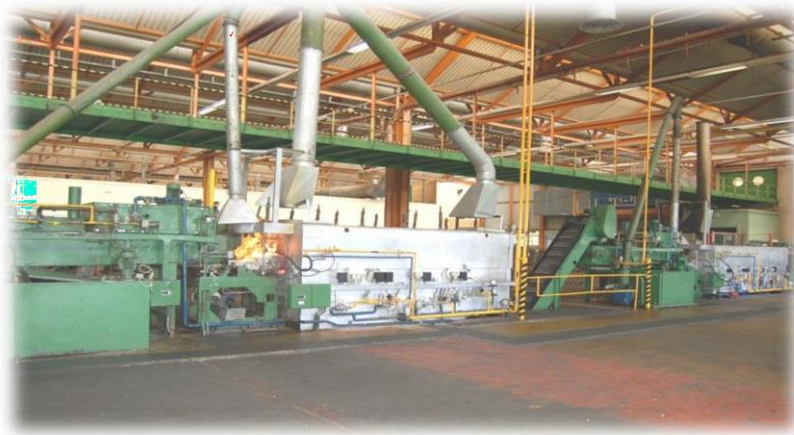
Fig.17 Station de traitement thermique
