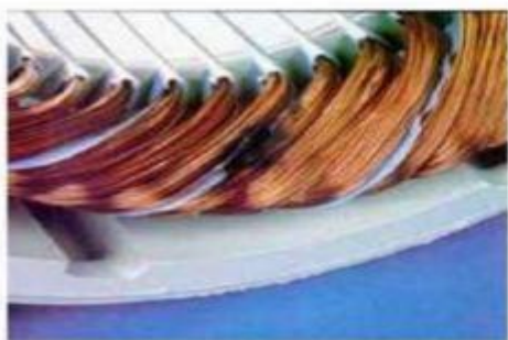
a) Court circuit dans une phase
