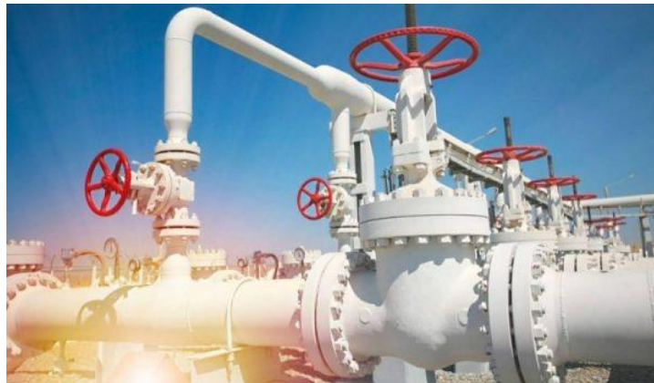
Figure 1.4 Station de Detente et de Regulation du Gaz Naturel
