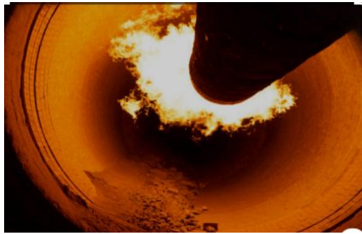
Figure I. 13 : Bruleur du four rotatif de ciment.
