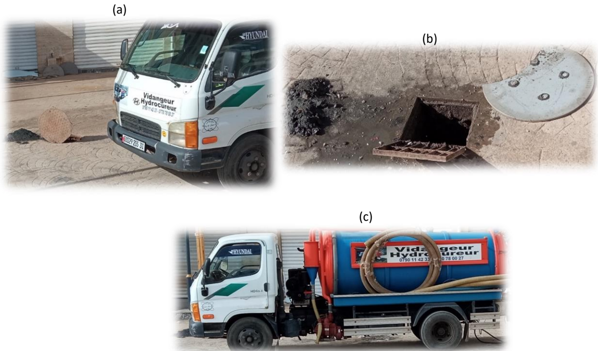
Figure III. 15: Débouchage de regards. (a et b) : regards bouchés. (c) : Camion vidangeur. (Enquête terrain, 2025).
