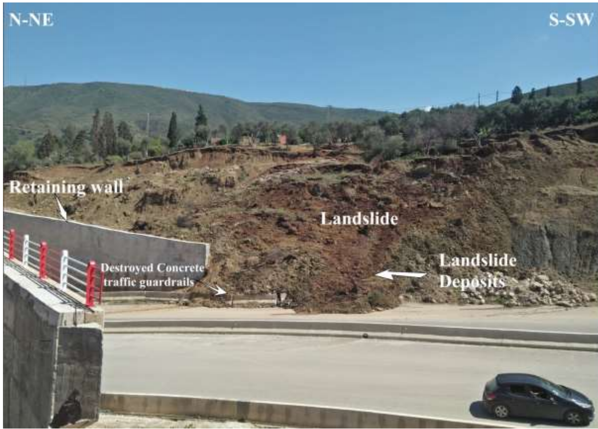
Figure.13 : réactivation du glissement de terrain L1 suite aux précipitations du 18/05/2018
