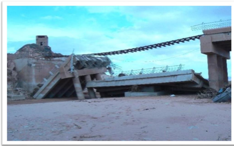
Figure 1 .I : Dégâts de la crue de 19 Octobre 2007
