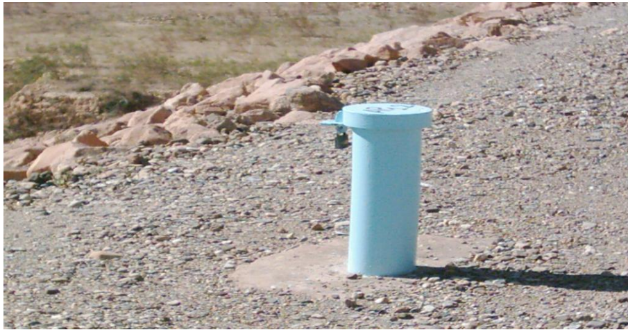
Figure N° III.4 : Piézomètre P1 du barrage gar gar
