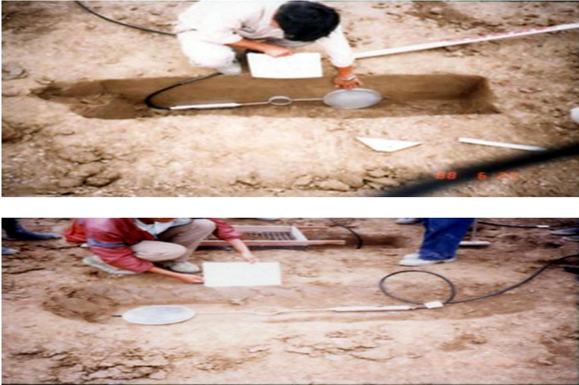
Figure N° III.6 : Raccordement des Cellules des pressions interstitielles de barrage Gargar
