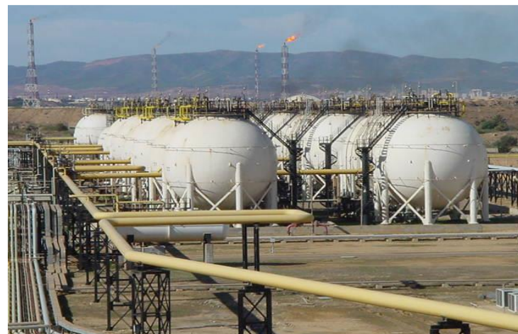
Figure 1.6-sphères de stockage de la charge : 22 000 m 3 [4].
