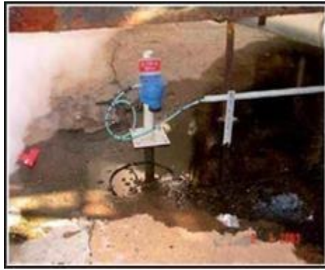
Figure 31: Exemple de détecteur de gaz dans une cuvette
