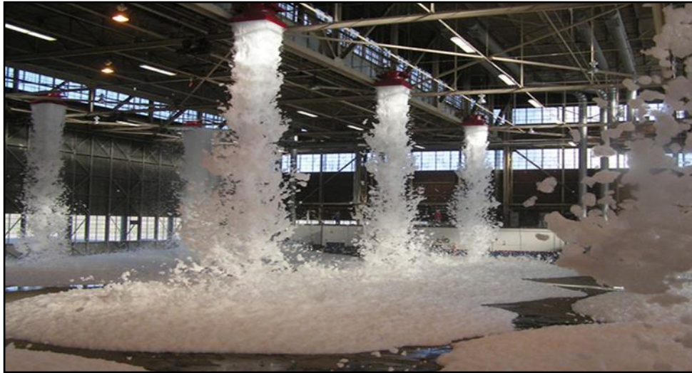
Figure 24 : la mousse d'extinction (Gielle).
