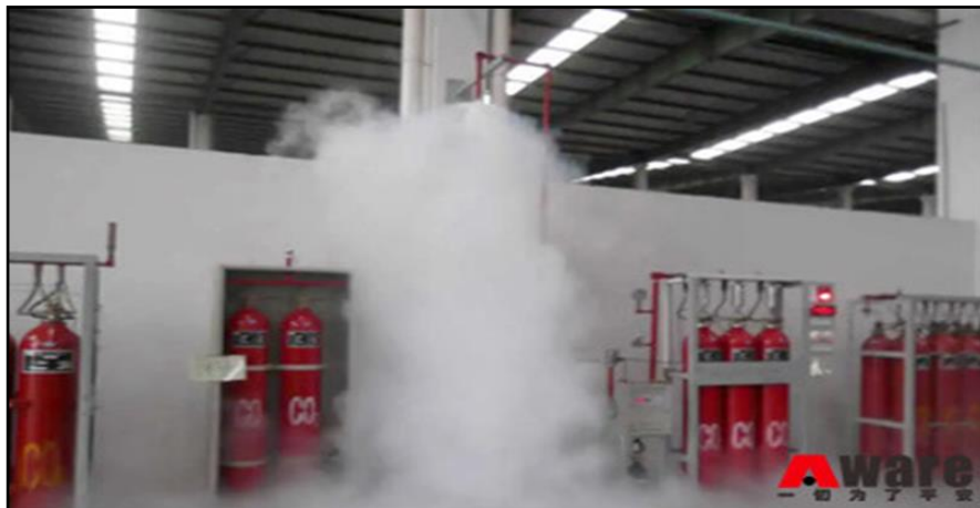
Figure 25 : système d'extinction à CO 2 (Aware Fire Technology Co., Ltd)
