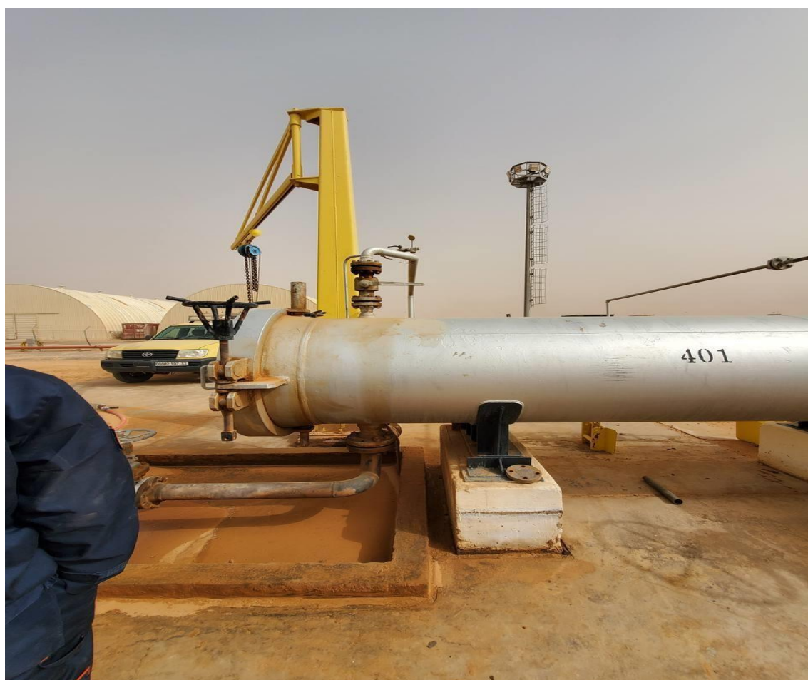
Figure 22 - Gare racleur arrivée de l'ouvrage OH1 du Terminal OHANET-
