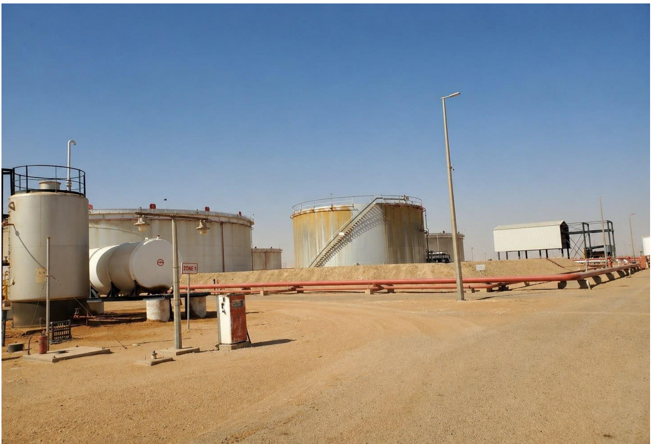
Figure 23 : Parc de stockage du Terminal OHANET - bacs à toit flottant -
