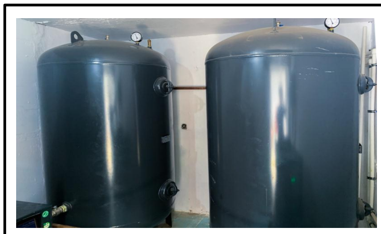
Figure 4.3 : Une réserve de stockage d'air comprimé.
