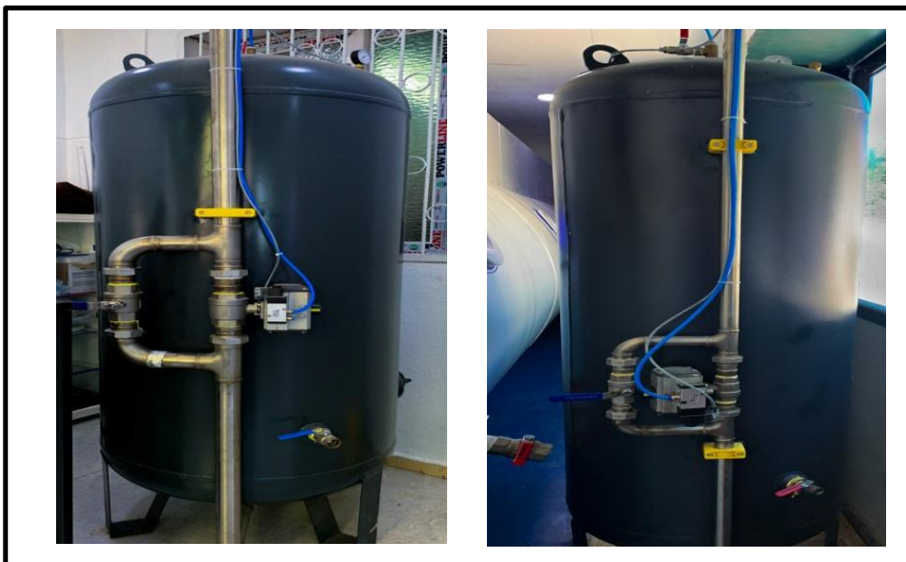
Figure 4.7 : Des cuves d'eau sous pression.
