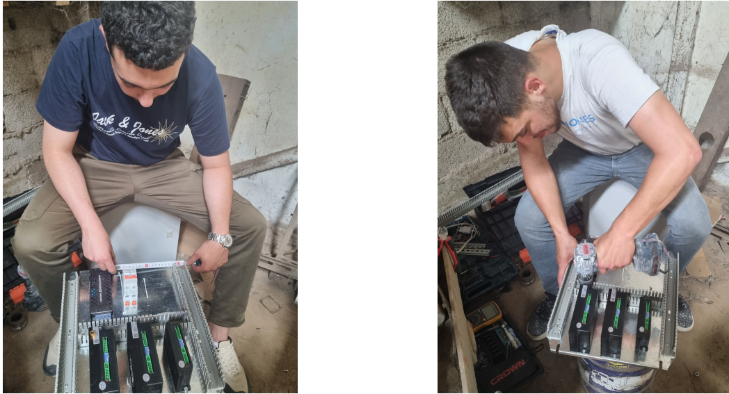
FIGURE 4.8. De la conception au montage de l'armoire électrique
