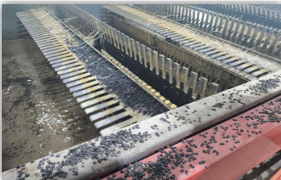
Figure II.6 : Vue intérieure de cuves
