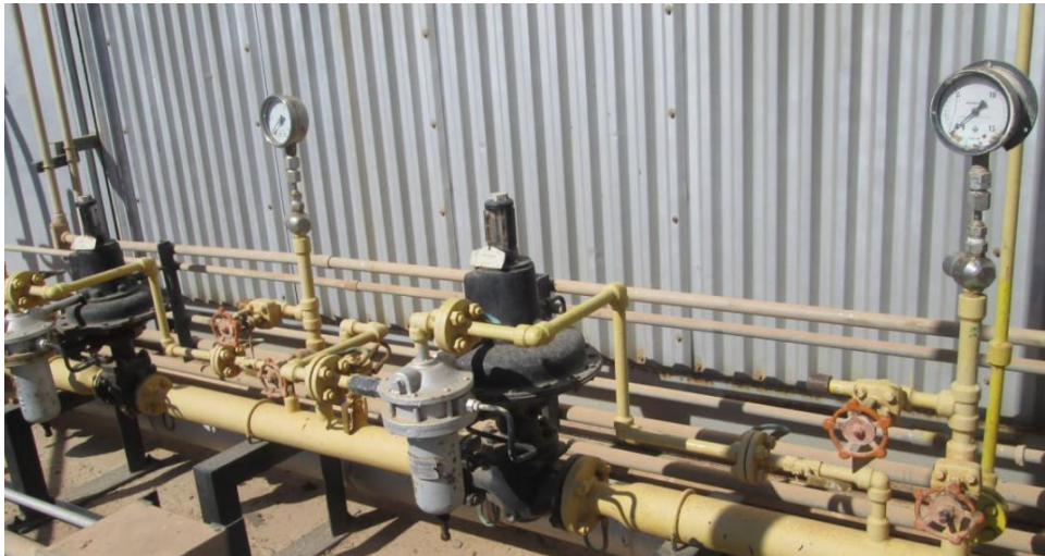
Figure II. 19: La rampe de régulation et de détente de gaz
