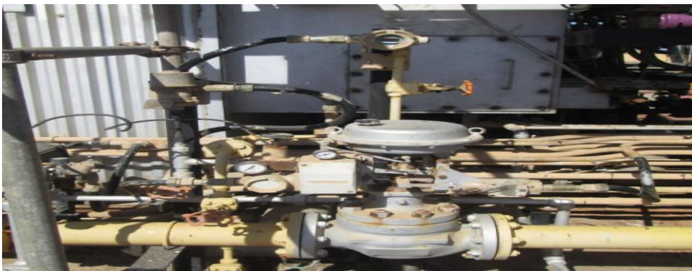
Figure II. 17: Vanne de Régulation Débit Gaz Combustible
