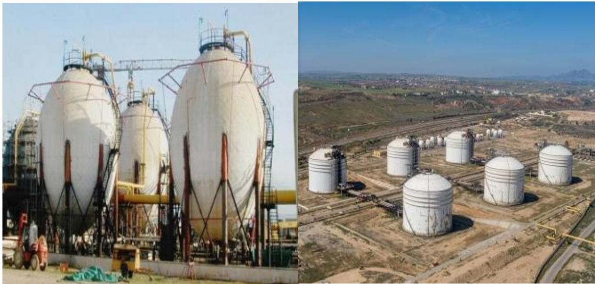
Figure II. 8: Stockage de propane et de butane
