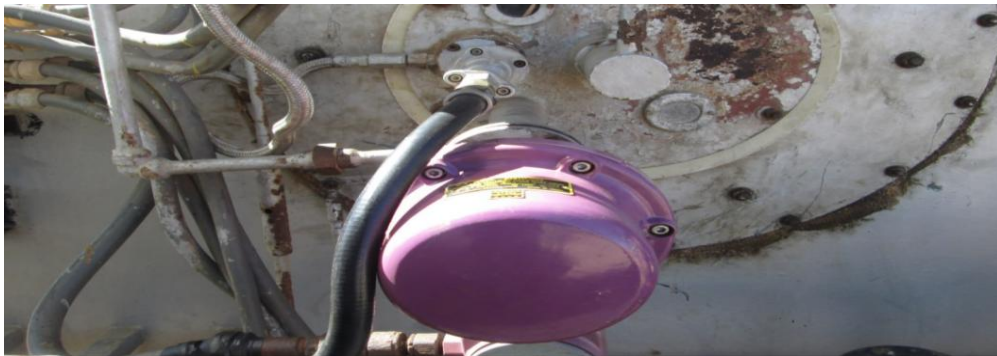
Figure II. 16: Détecteur de Flamme
