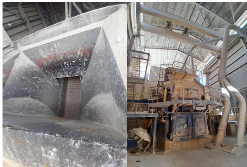
Figure I-4. Concassage de la matière premier dans une cimenterie
