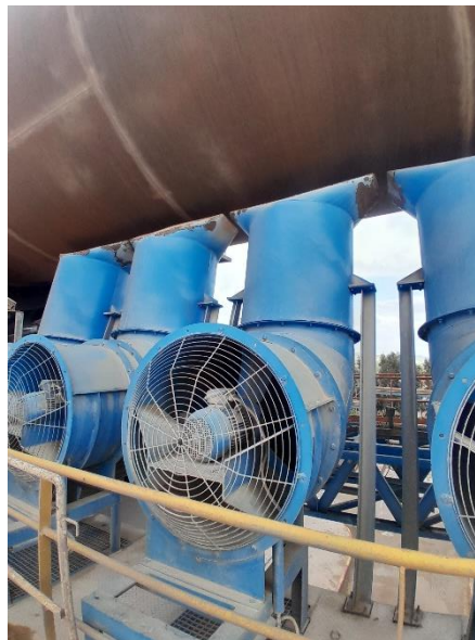
Figure I-15. Ventilateurs de refroidissement de la virole du four rotatif
