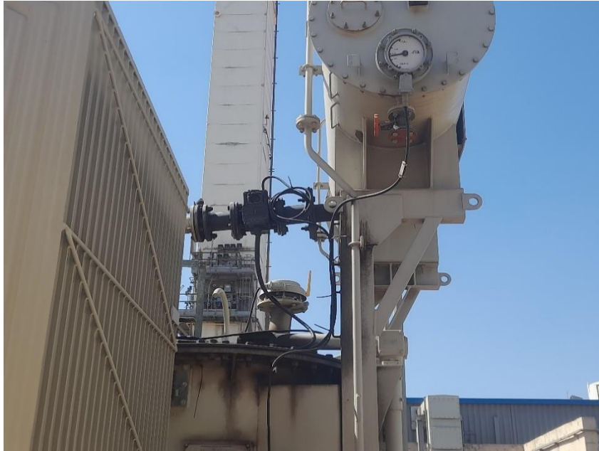
Figure 4-2 : Maintenance d'un transformateur enpuissance
