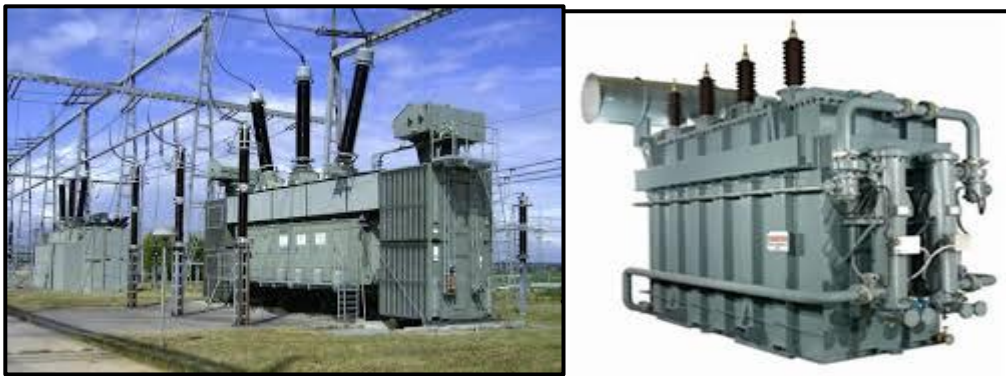
Figure 1-2 et 1-3: transformateur de puissance
