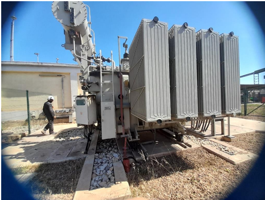
Figure 4-1 : transformateur de puissance
