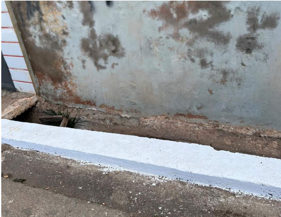
Photo..... canalisations des eaux de sources et pluviale dans le village de kristel
