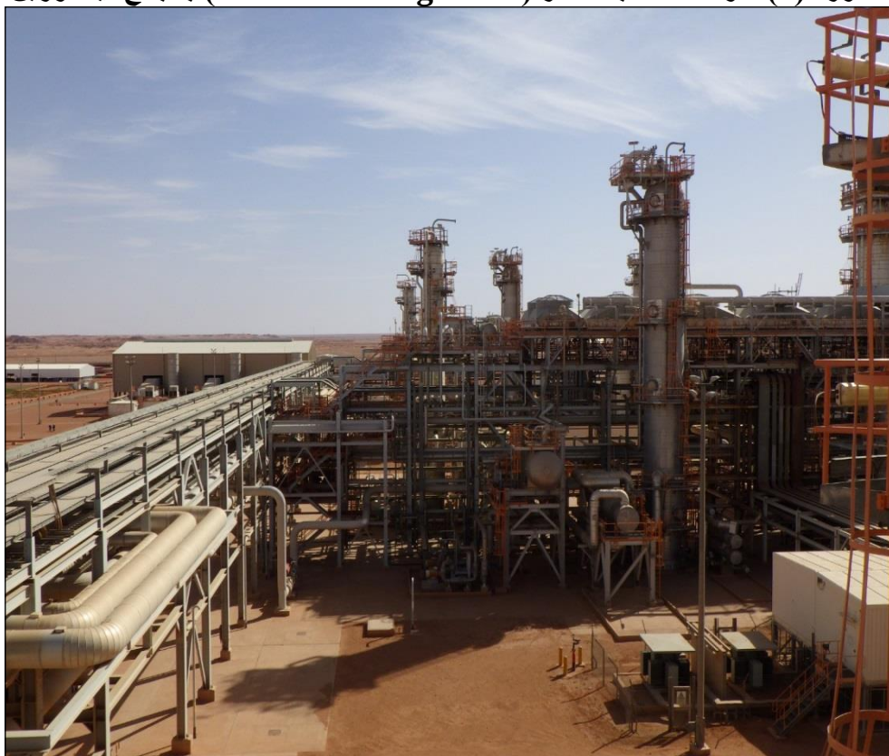
الصورة (2) : وحدة معالجة الغاز (Gas Processing Train) بمجمع تيفنتورين
